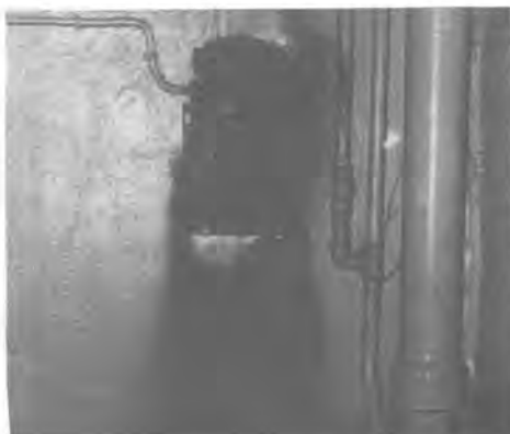
Spuren eines Brandanschlags in der Cuvrystr. 25
