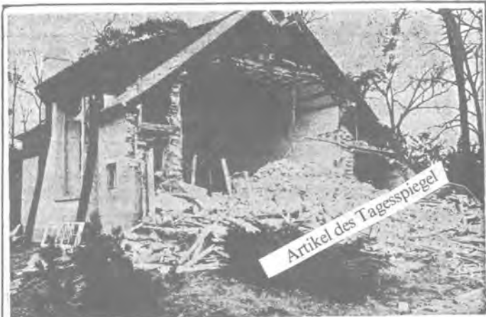
Abriß ohne Genehmigung. Der Eigentümer dieses und eines benachbarten Hauses am Kleinen Wannsee ließ am Wochenende das Mauerwerk einreißen, obwohl er keine Abrißgenehmigung hatte. Den herbeigeeilten Mitarbeitern der Bauaufsicht wurde, als die Zerstörung noch nicht so groß war, erklärt, es werde nur das Dach erneuert. Foto: Mrotzkowski
